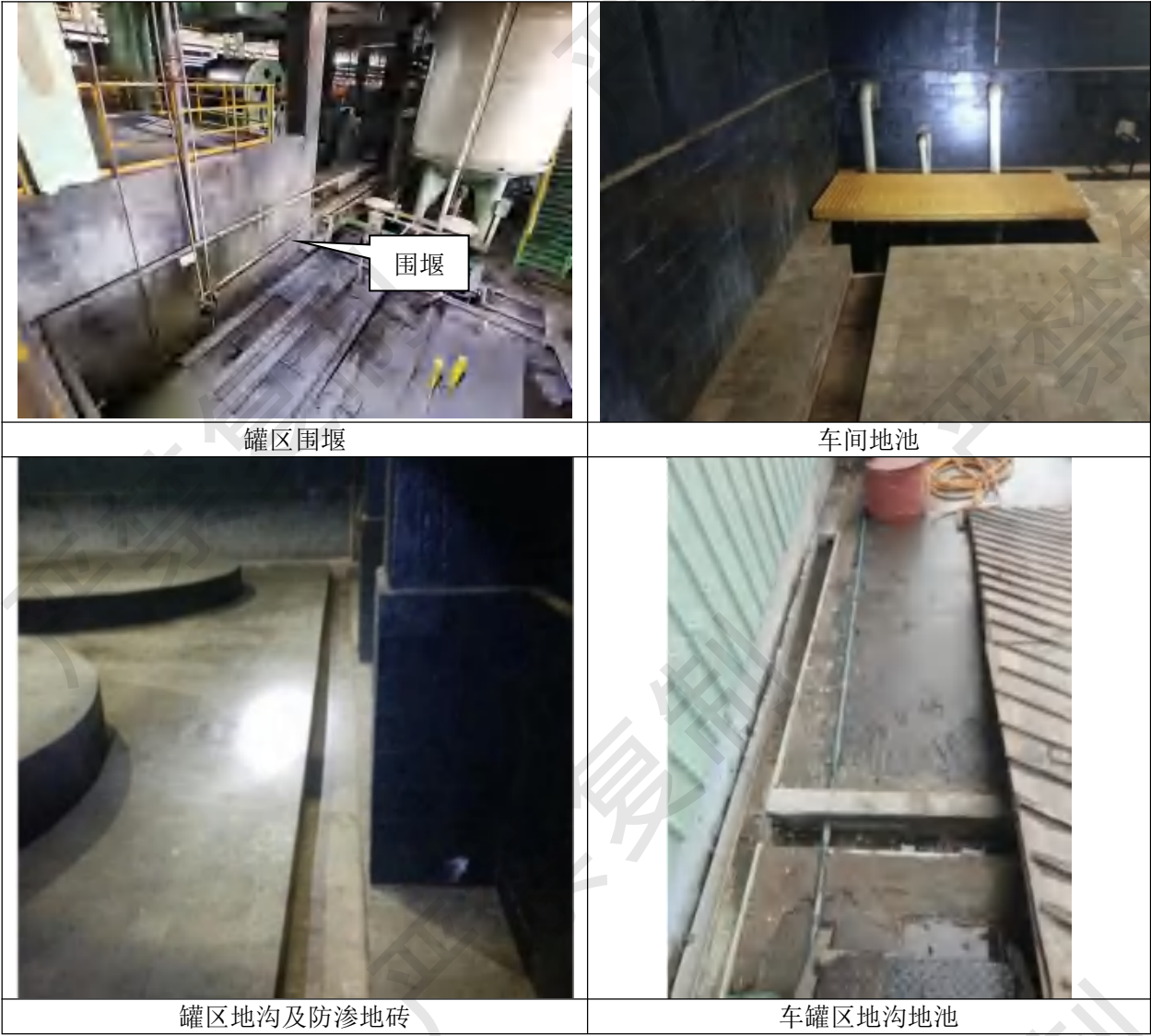
图 4.2-2 罐区应急设施
